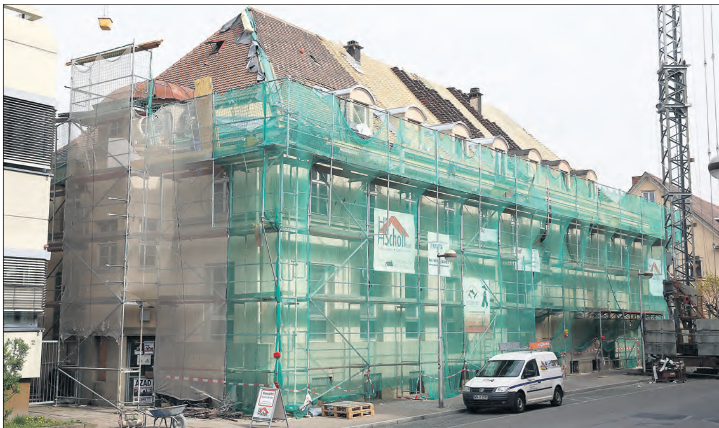
Wird mit alten Ziegeln neu eingedeckt: Das künftige Wohnheim der Paulinenpflege in der Bahnhofstraße.
